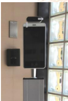
検温器を設置しました。
