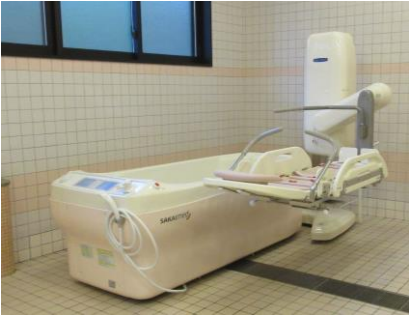
特殊浴槽を設置。
